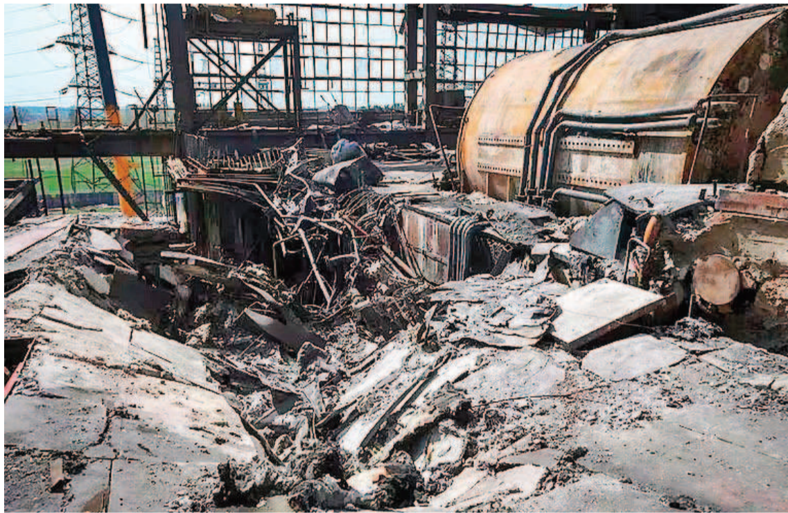
Una instalación de infraestructura eléctrica crítica destruida que fue alcanzada recientemente durante un ataque con misiles de Rusia.
