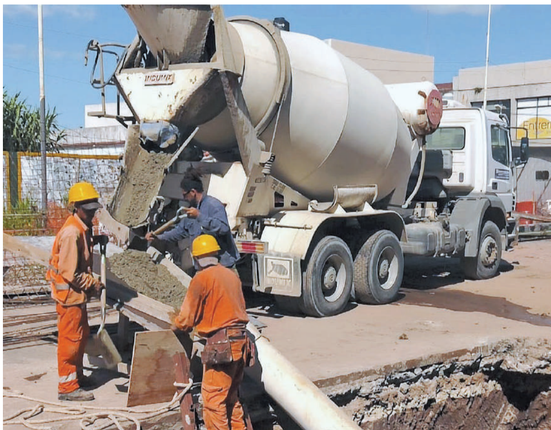
Los trabajos sobre el socavón que se formó en Avenida Almafuerite comenzaron a principios de diciembre.
