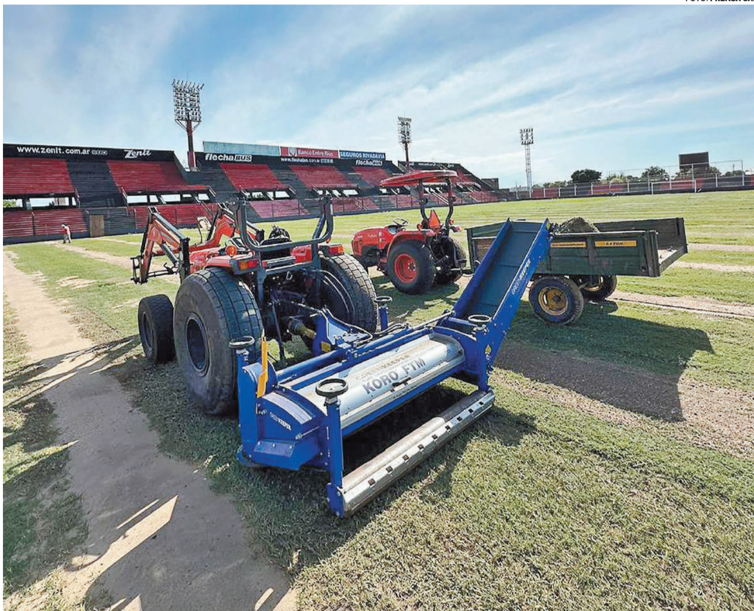
Patronato compartió algunas imágenes de cómo van las obras en el estadio Presbítero Bartolomé Grella. El club realiza trabajos complementarios en el campo de juego.
