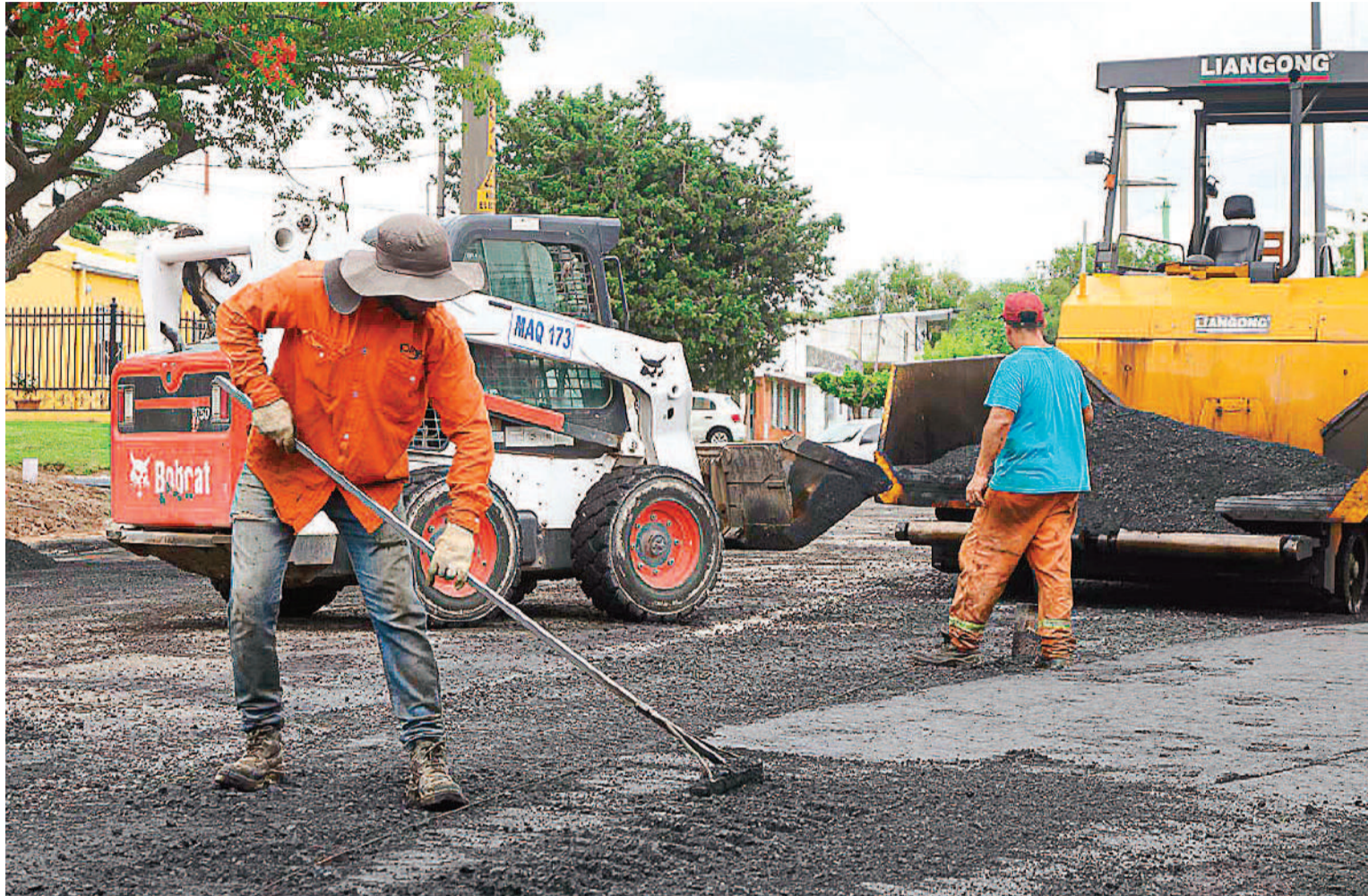
Se colocaron las últimas 300 toneladas de asfalto y se habilitó el tránsito.
